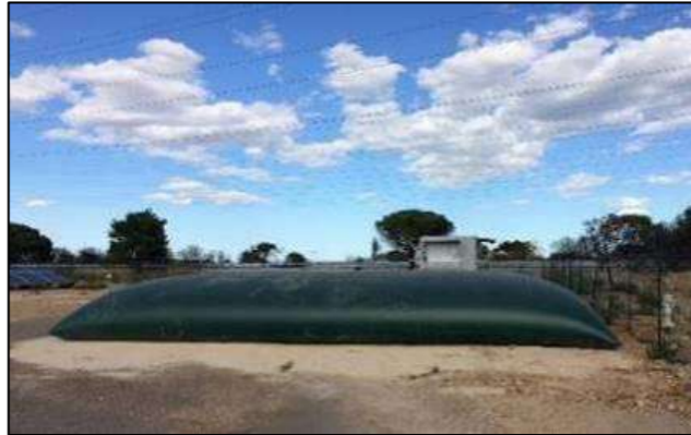
Figure 38 : Exemple d'une citerne souple (Source : EDF RENEUVABLES)
