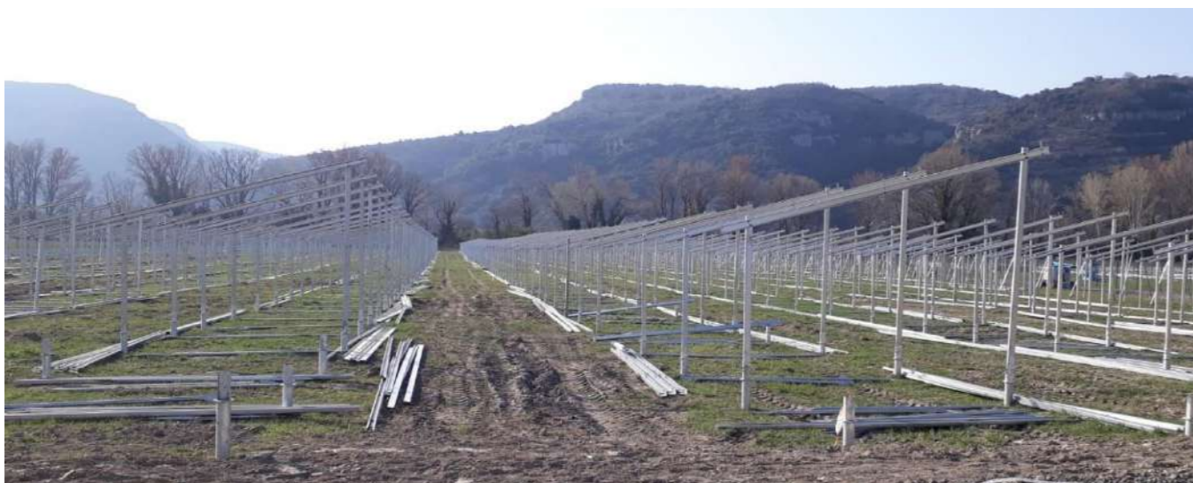
Figure 31 : Exemple de structures et fondations par pieux en acier (source : EDF RENEUVABLES)
