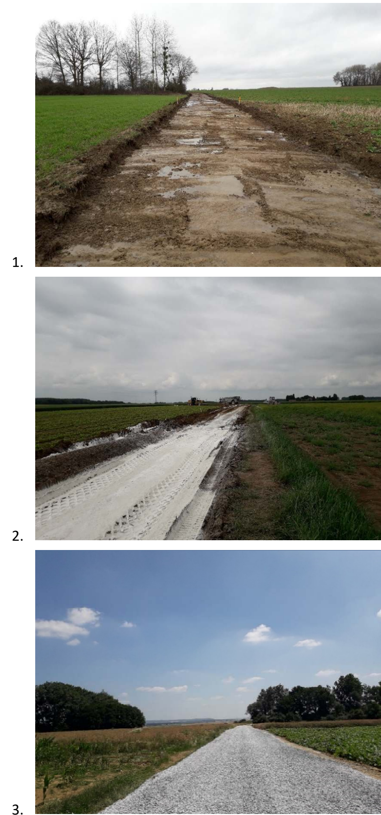
Figure 53 : Création de chemin 1 - Décapage, 2- Traitement à la chaux, 3 – Etat final (Source : VOLKSWIND)
