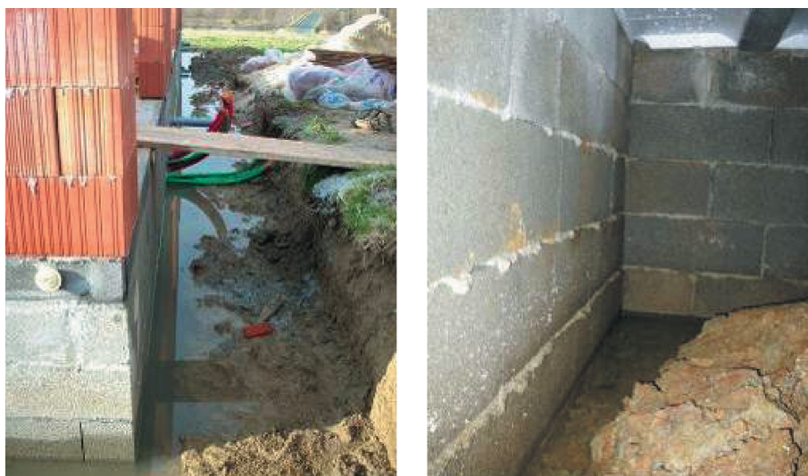
Figure 4 Stagnation des eaux à l'extérieur (gauche) et à l'intérieur (droite) (Source Socabat)
