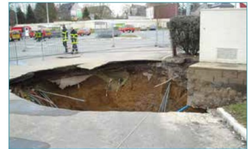
Illustration 1.27 : Effondrement de chaussée, Bapaume (62) [crédit BRGM, sd]
