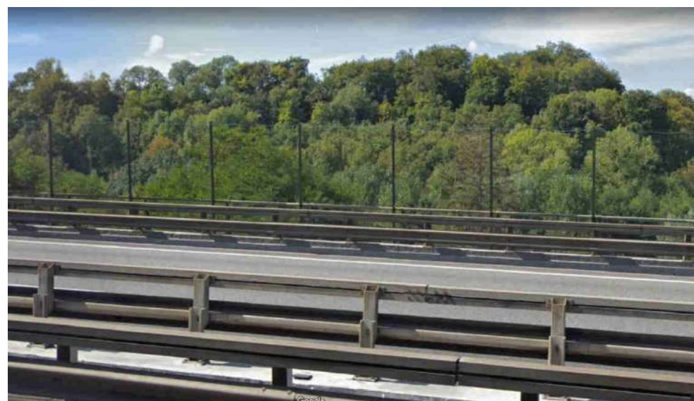
Exemple de dispositif anticollisions sur viaduc (autoroute A1)
