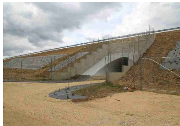
Dispositif de type auvent et grillage de guidage en tête d'ouvrage (©INGEROP)
