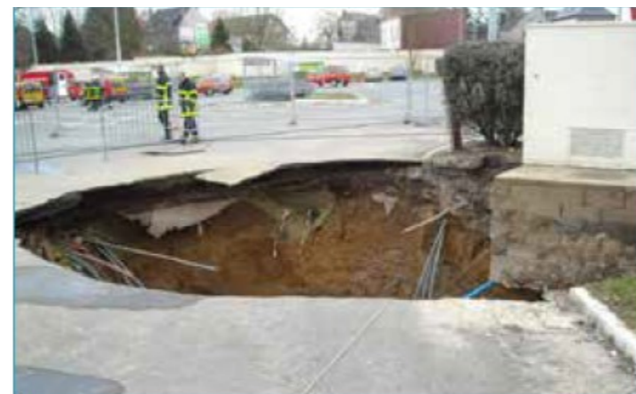
Illustration 1.27 : Effondrement de chaussée, Bapaume (62) [crédit BRGM, sd]
