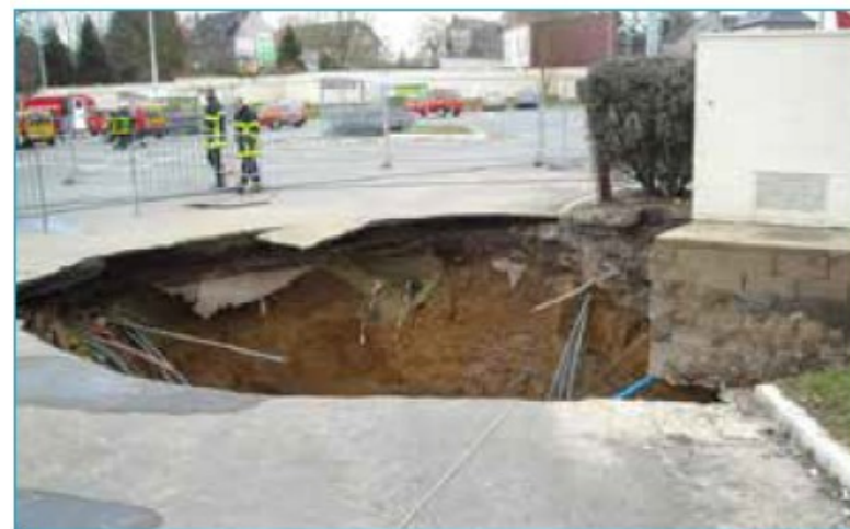
Illustration 1.27 : Effondrement de chaussée, Bapaume (62) [crédit BRGM, sd]
