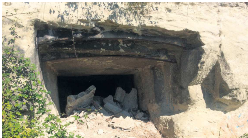
Les cavités souterraines refont surface à Antoigné et représentent un risque potentiel d'effondrement qui inquiète les habitants concernés. (Photo archives Denys Frétier)
