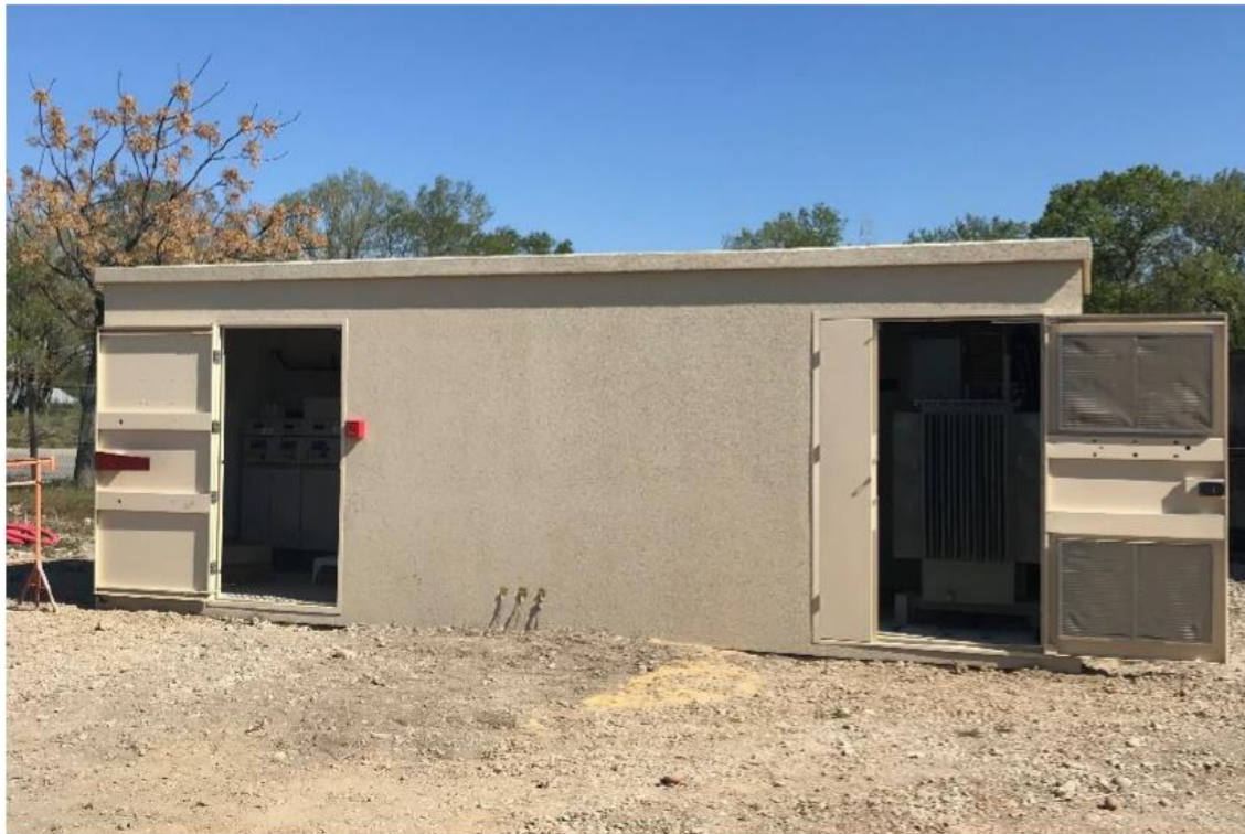
Figure 5 : Photographie d'un poste de livraison/transformation
