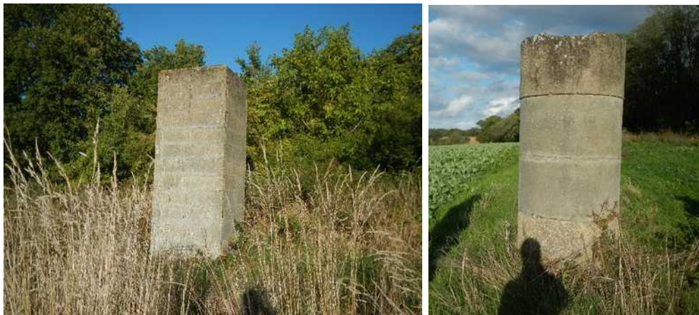
Figure 7 : Photos de cheminées d'aération (source : Ineris)
