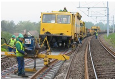
Longs Rails soudés sur traverses béton
