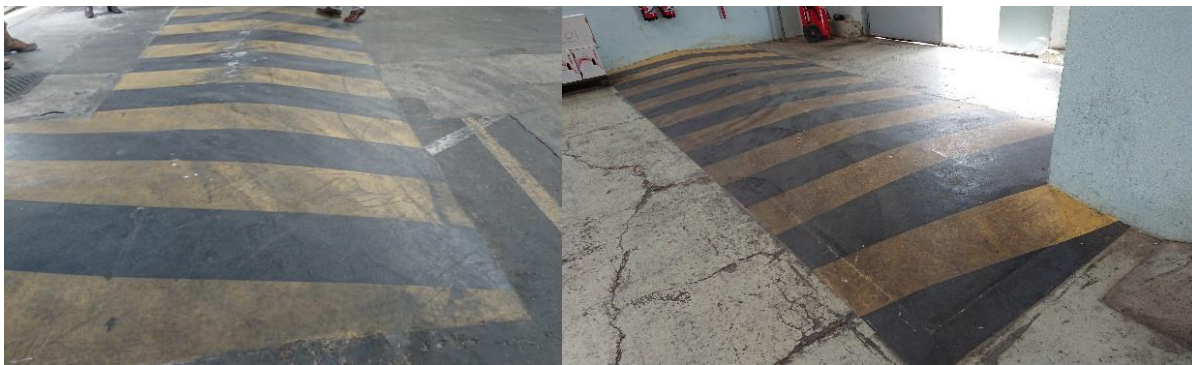
Figure 24 : Prise de vue des dispositifs de confinement des eaux d'extinction incendie au droit des bâtiments de stockage existants (©AHIDA Conseil, 28/04/2020)
