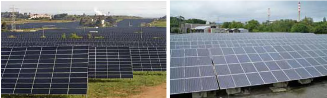
Photo 2 : Les installations fixes au sol
