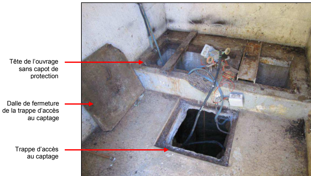
Figure 13 : tête du captage de la source de la Preille
