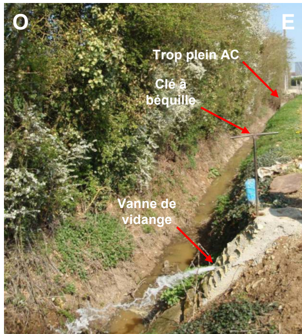
Figure 58 : vanne de vidange du réseau d'eau potable
