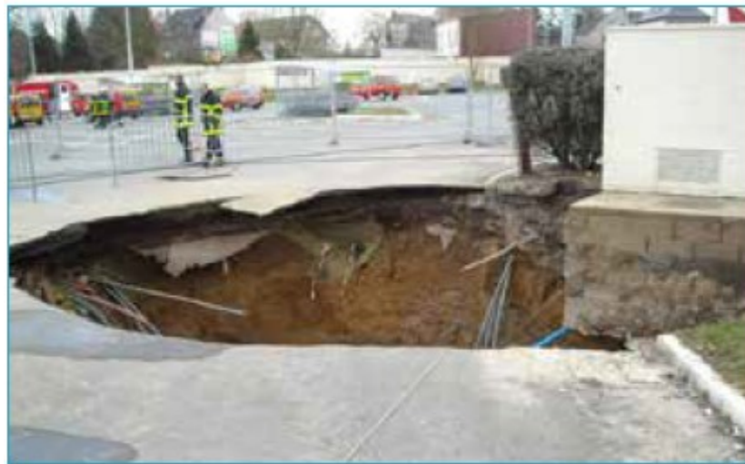
Illustration 1.27 : Effondrement de chaussée, Bapaume (62) [crédit BRGM, sd]
