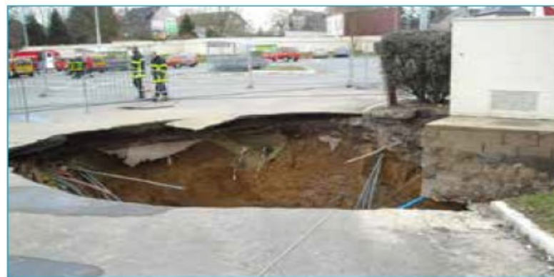
Illustration 1.27 : Effondrement de chaussée, Bapaume (62) [crédit BRGM, sd]
