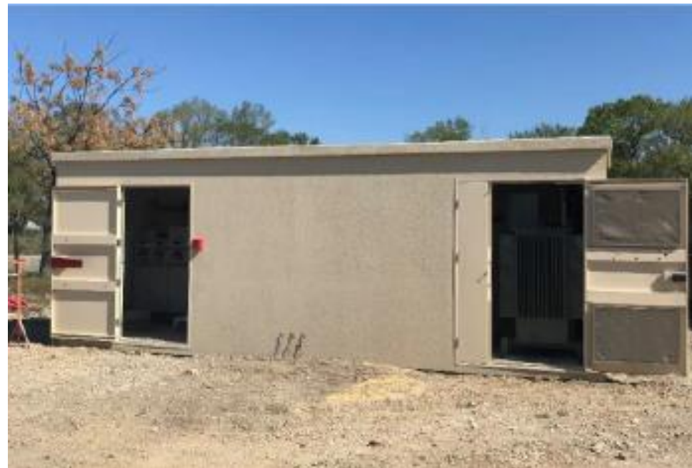
Poste de transformation électrique
