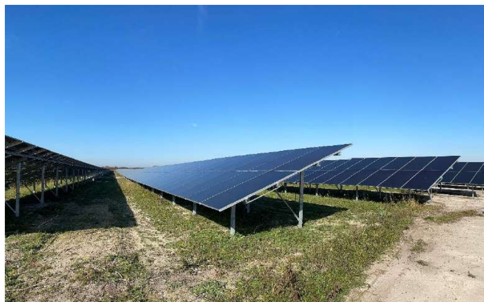
Figure 44 : Exemple d'installation photovoltaïque réalisée à Marigny (51) par le porteur de projet
