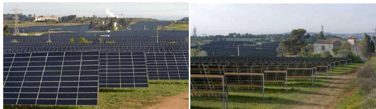
Photo 36 : Illustrations montrant le développement de la végétation sous les panneaux photovoltaïques
